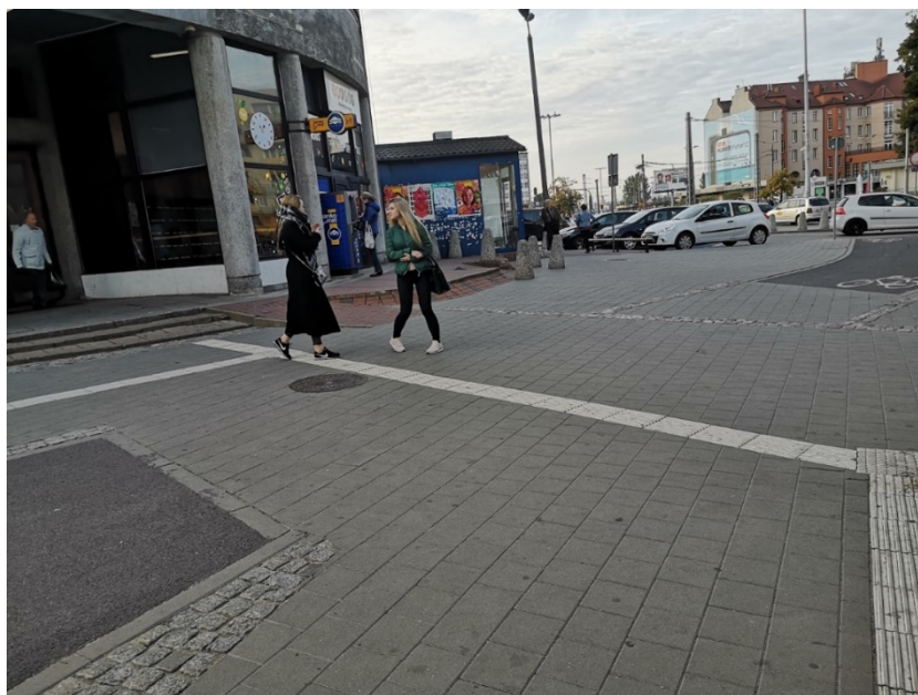
Zdjęcie 3 Dworzec Kolejowy w Gdyni - przerwanie ciągłości nawierzchni drogi dla rowerów.
